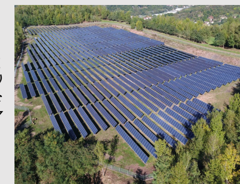
Centrale Solaire de DECAZEVILLE Département de l'Aveyron (12) Puissance électrique : 11 400 kWc Mise en service : 2017
